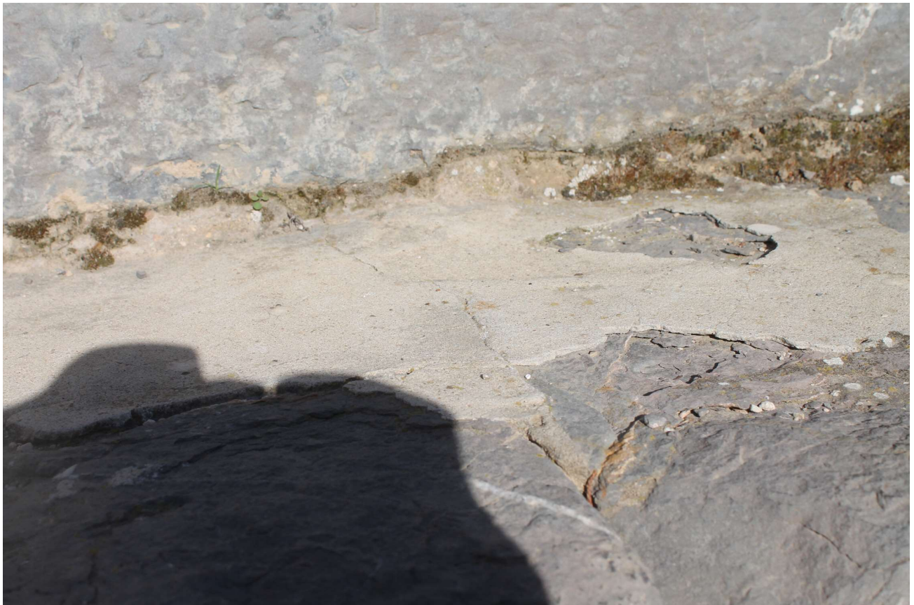
Deteriroy en elemnto de piedra.
